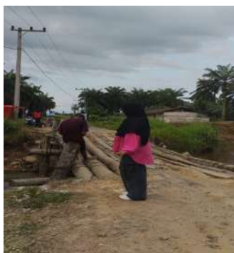
Gambar 5. Dokumentasi Jalan Rusak Belum Di Perbaiki akibat bencana banjir
