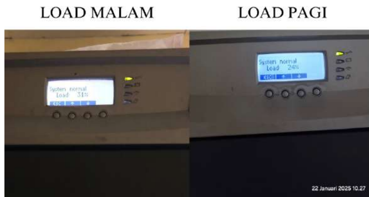
Gambar 8. Load Pagi dan Load Malam UPS Gardu Terminal
