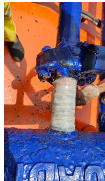
Gambar 3. Kondisi Pipa Liquid Line Setelah Penambalan Kebocoran Sumber: Dokumentasi MT. Gas Estella (2025)
