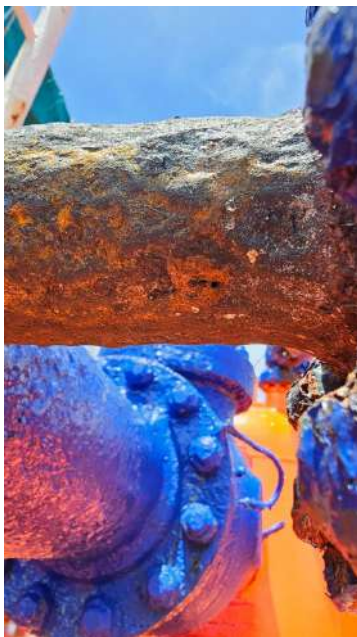
Gambar 1. Kondisi Kebocoran pada Pipa Liquid Line Sumber: Dokumentasi MT. Gas Estella (2025)
