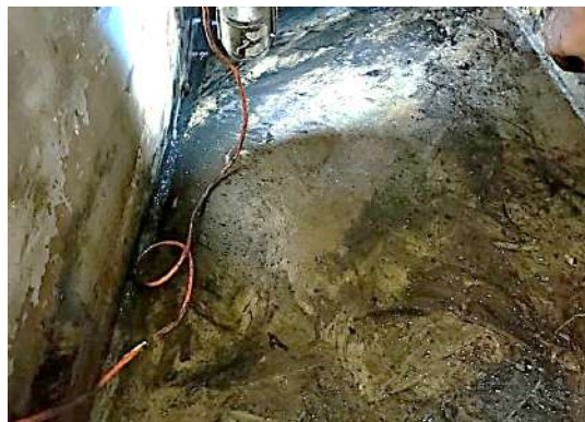
Gambar 4. Tangki Service Bahan Bakar yang Kotor
