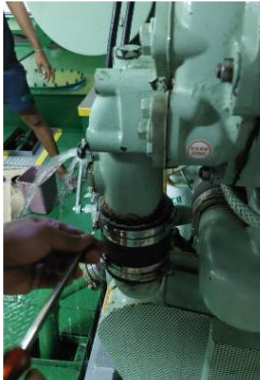
Gambar 2. Rembesan Air Laut pada Area Mechanical Seal
